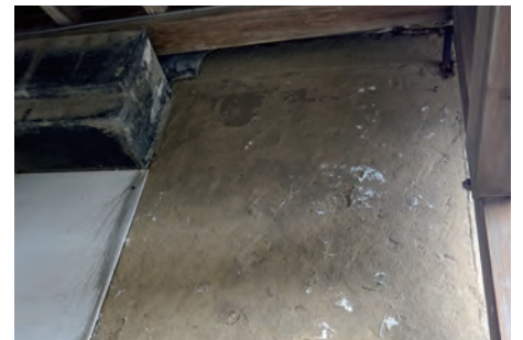
漆喰が落ちて土壁が剥き出しに。
