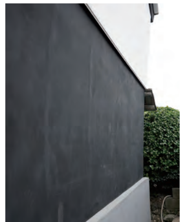
黒漆喰は施工直後に気温が低下すると白華が生じやすいため、押し寄せる寒波と闘うような気持ちで施工に取り組みました。
