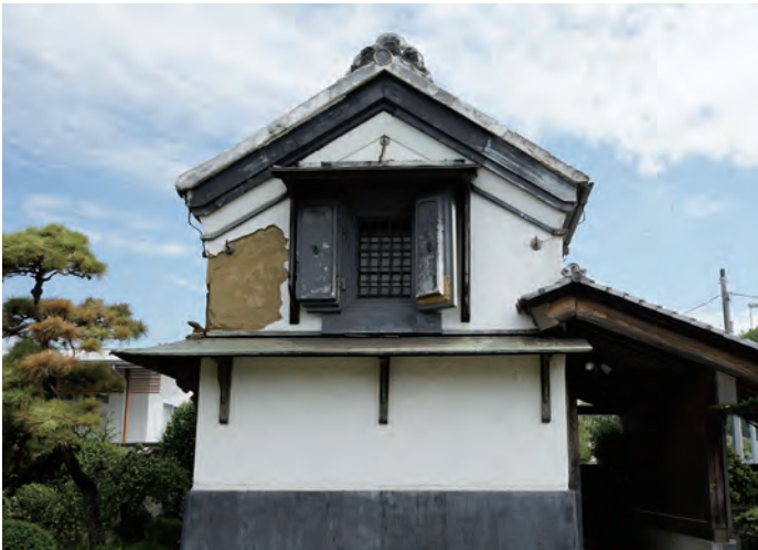
観音扉や鬼瓦にも欠損やDIYの跡が見られます。
