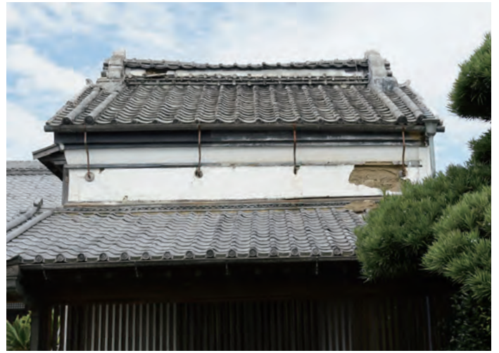
実は漆喰の下で壁全面に剥離が進んでいた2階壁。
